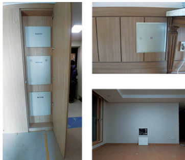
<설치 및 유지·보수 용이성 및 화재발생 우려를 개선한 세대단자함 설치 사례>
